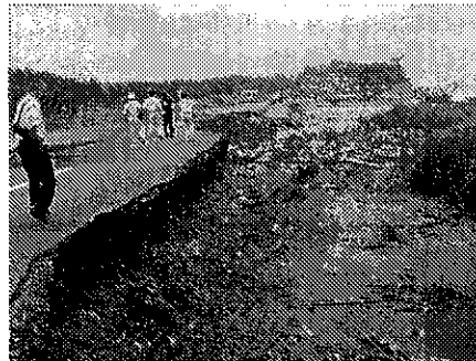
沿岸近くの寸断された道路
