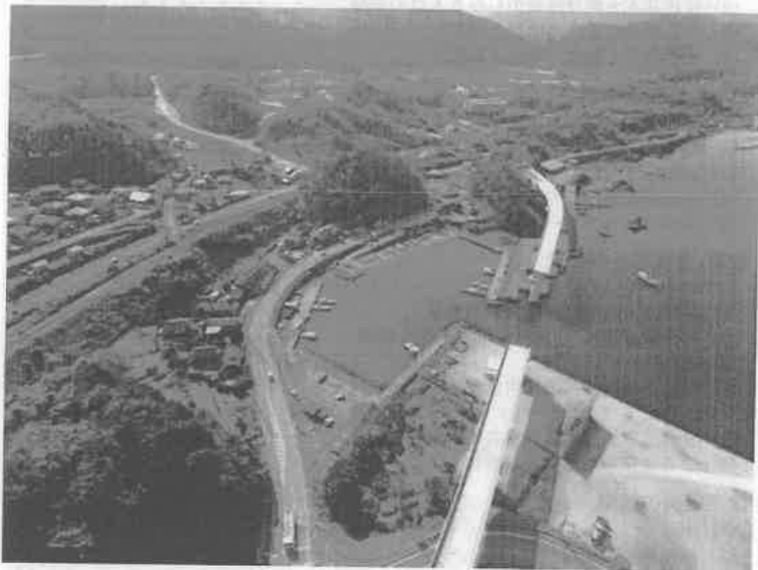
平成 29 年度の完成に向け建設工事が進む 臨港道路福井 4 号線
