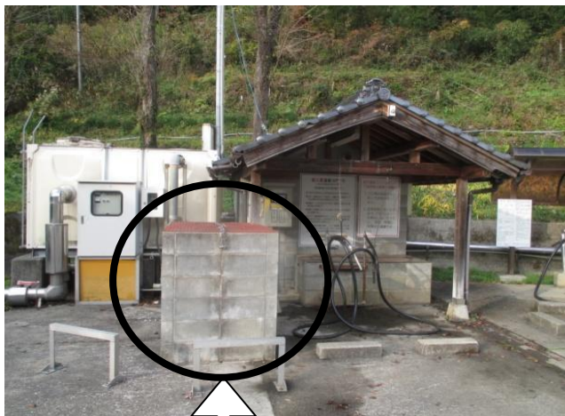
水中ポンプ設置箇所
