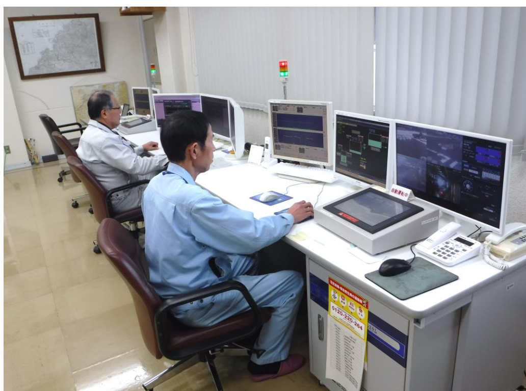
【美川浄水場・水道施設監視システム】
