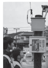
設置された防犯カメラ
