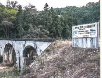
● 第一下府川橋梁・4連アーチ橋 新線は、下府駅を起点とする旧線の路盤を利用せず、浜田駅から直線的な線形をとりました。新旧未成線の橋梁が同時に見られる遺構は、全国的にもたいへん珍しい存在です。
