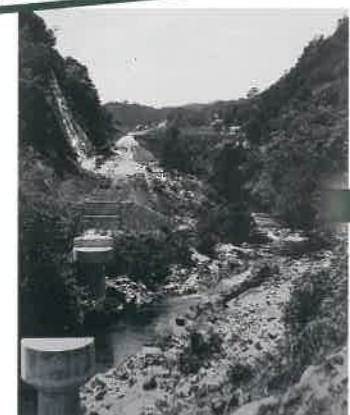
今福第五トンネル付近 (昭和14年頃) 今福第五トンネルを抜け下府川を渡る工事現場。まっすぐ佐野地区へ向かう路盤上にはトロッコのレールが見えます。
