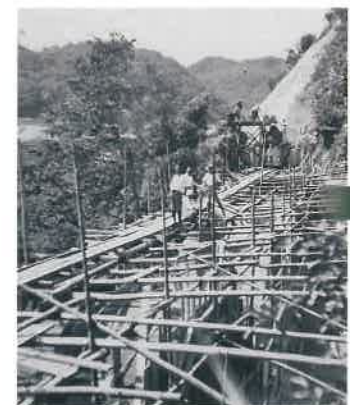
おろち泣き橋 (昭和13年頃) 下府川沿いに建設中の4連アーチ橋。当時は杉の丸太を使って足場を組んでいた様子がわかります。
