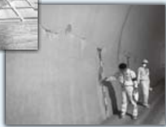
農道のトンネルの亀裂
