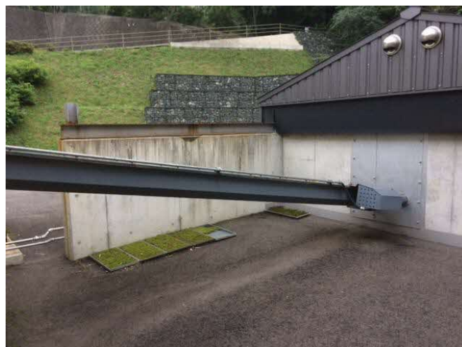
②⑦燃料排出コンベア
