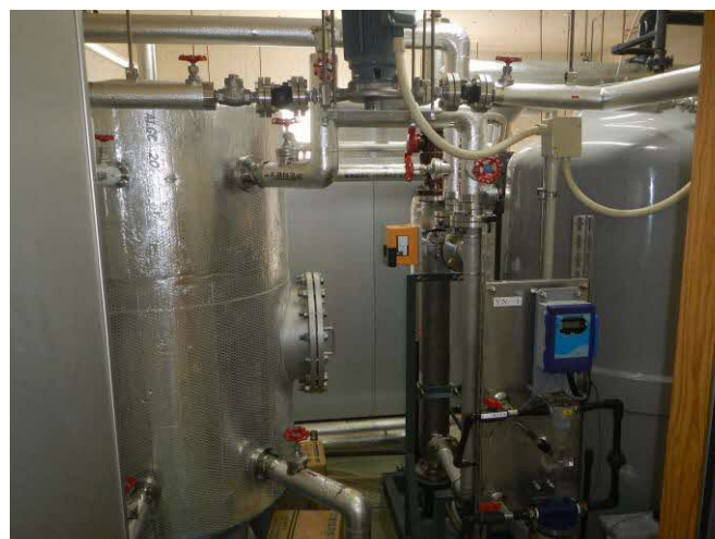
⑦機械室（重油ボイラー）
