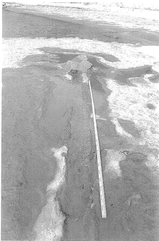
き損状況近景(西より)
