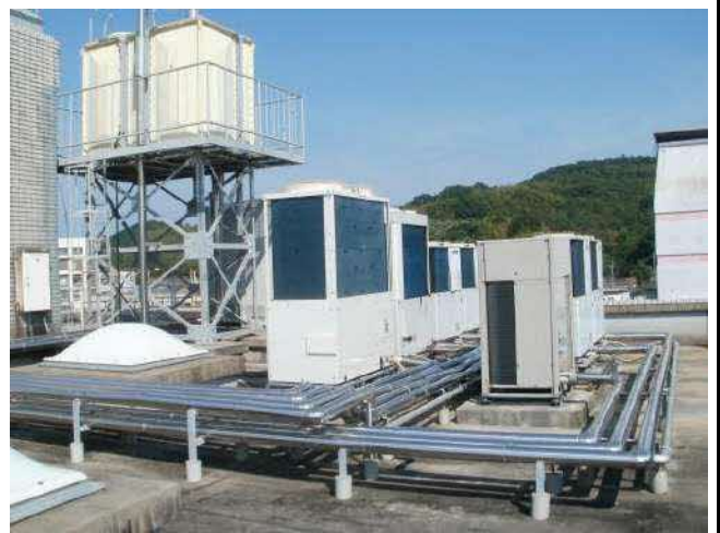
屋上 (エアコン室外機7機、高架水槽など)
