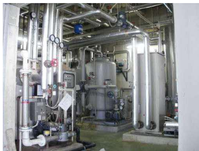
1階 機械室 (ボイラー、ろ過器など)
