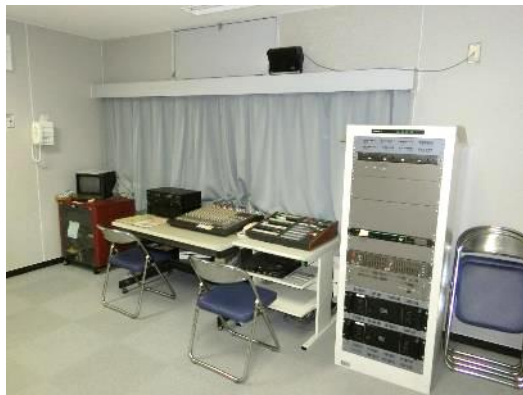
A 競技場_放送室
