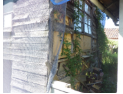
外壁材の腐朽
