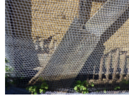
土台部分の腐朽
