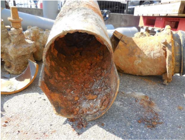
(老朽化した管路内面の錆)
