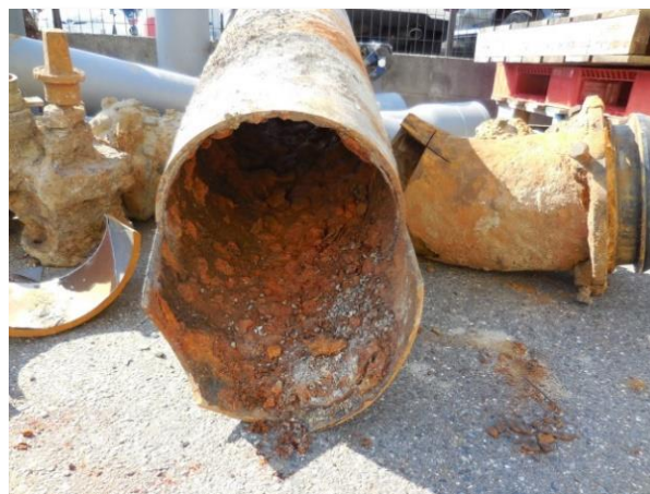
錆びた水道管
