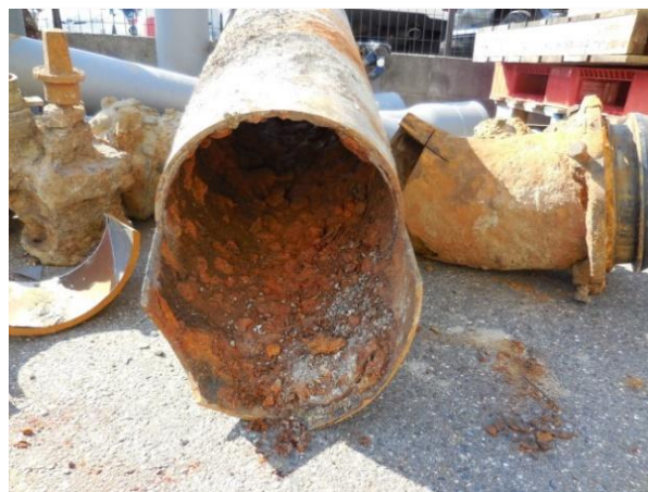
錆びた水道管
