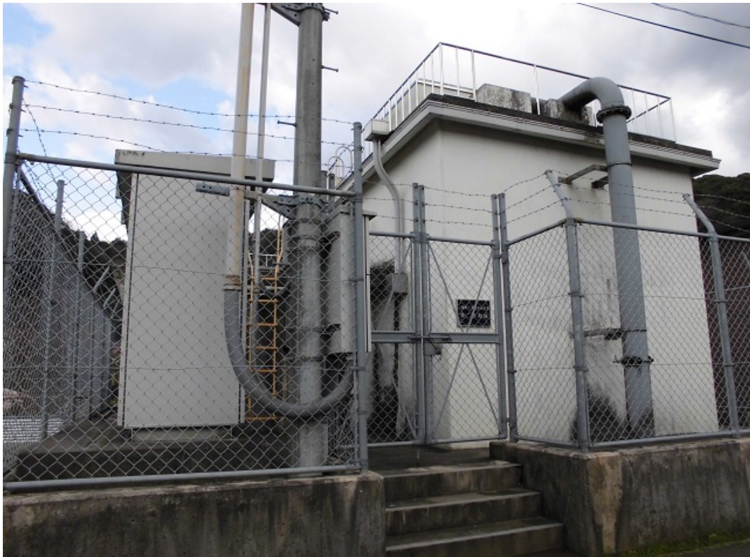
浜田市工業用水道事業 第2水源地
