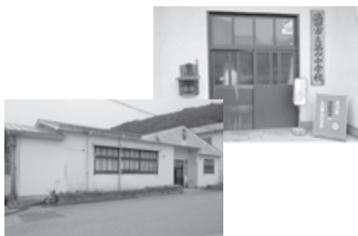
▲老朽化した学校施設▲
