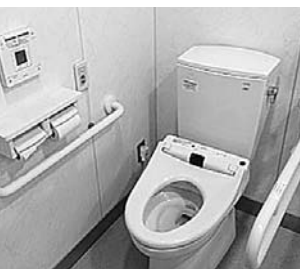
長浜小学校の洋式トイレ
