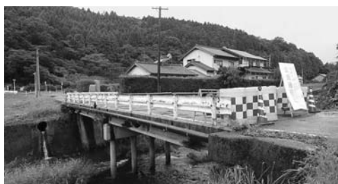
通行不可となった橋
