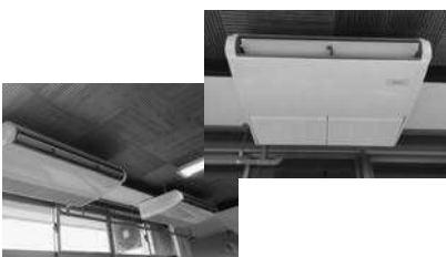
小中学校の全ての普通教室に設置されたエアコン
