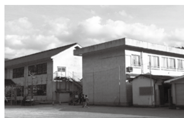
一日も早い建替えが望まれる、老朽化の著しい美川小学校と第四中学校
