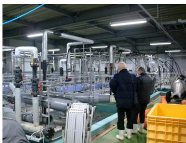
配管は、全て最新鋭のろ過機に繋がっている
