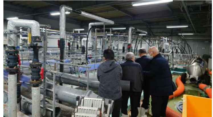
閉鎖循環式陸上養殖システム
