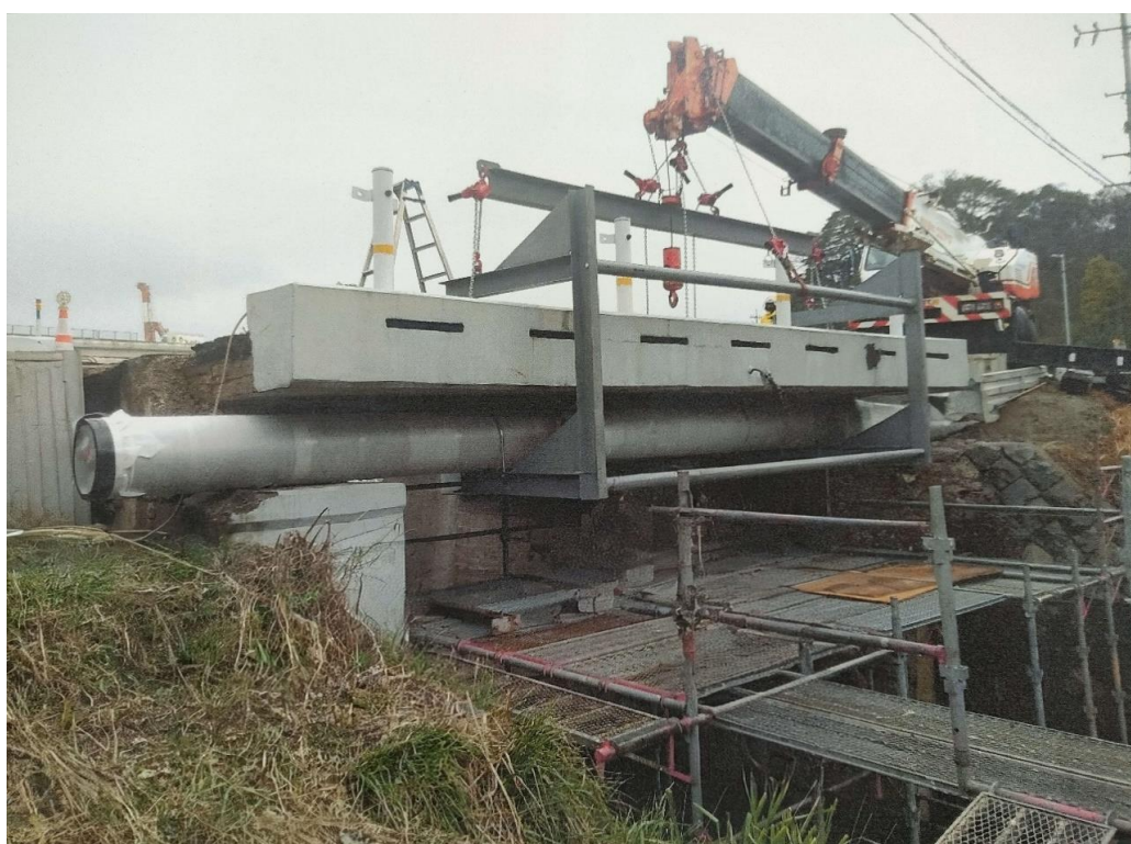
【福井橋・橋梁添架管φ400】
