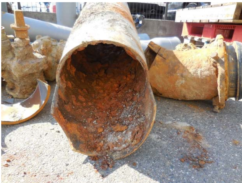
(老朽化した管路内面の錆)
