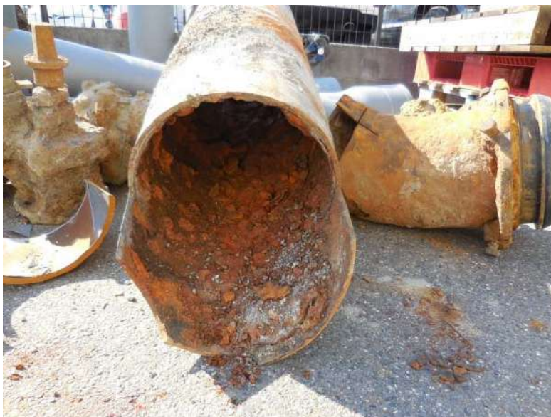
(老朽化した管路内面の錆)
